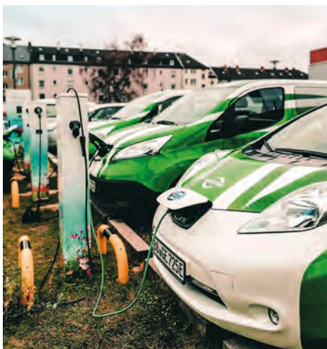
Foto: BOGESTRA, E-Pkw-Ladesäule, Hauptverwaltung
